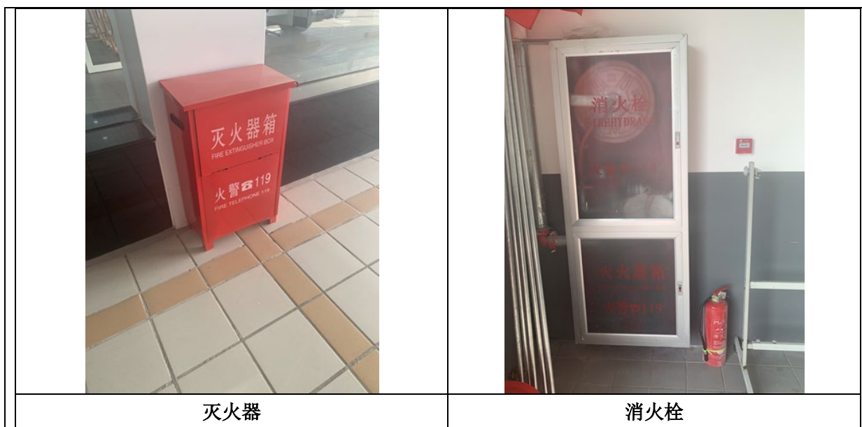
图3-10 风险防范设施照片
