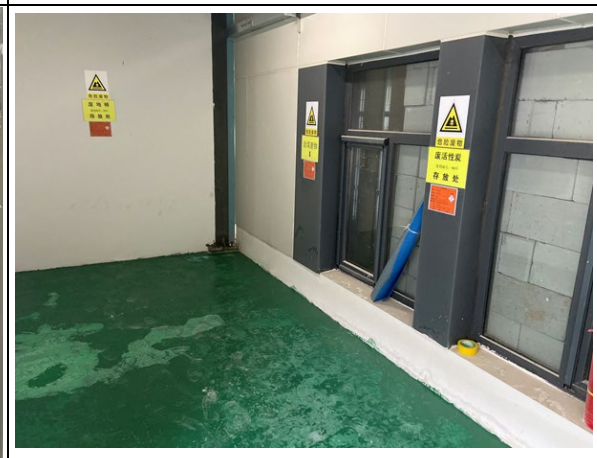
2#危废暂存间内部照片(防渗涂层、分类存放)
