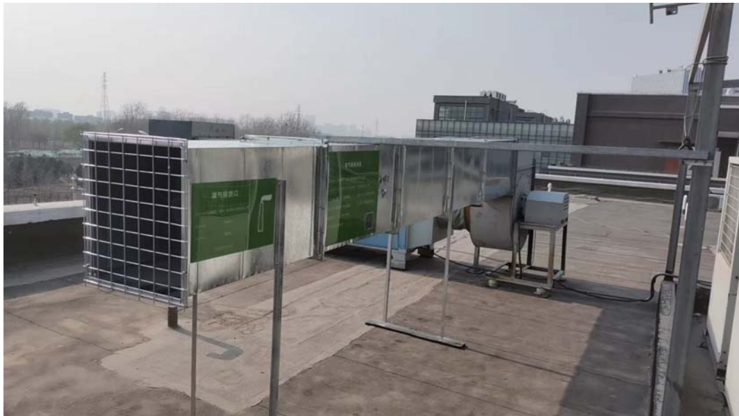
废气监测点位标识牌及废气排放口标识牌
