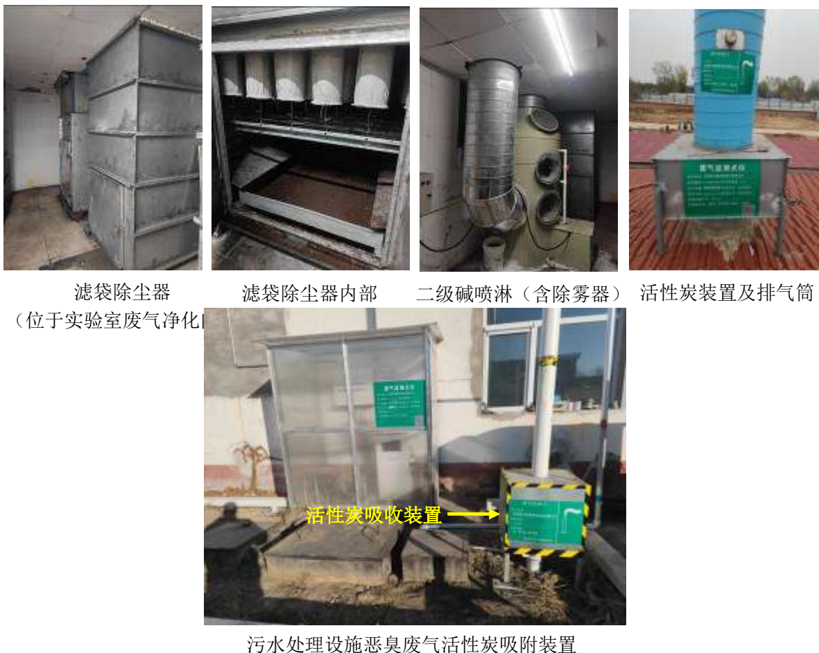
图 3-3 废气处理设施现状照片
