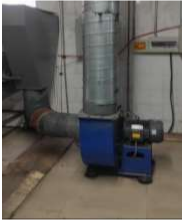
建材制品单体燃烧试验装置 设置基础减振
