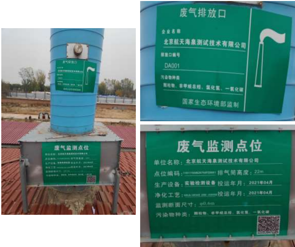
防火建筑材料检测燃烧试验废气排气筒 DA001
