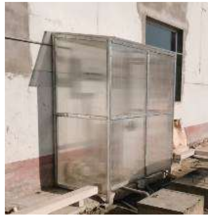
一体化污水处理设施鼓风机隔声罩
