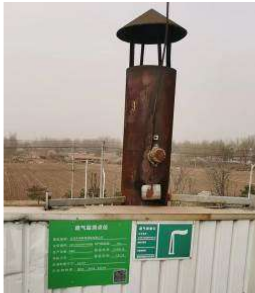
DA006 废气排放口及监测点位标识牌
