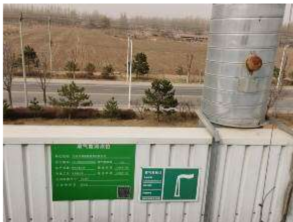
DA003 废气排放口及监测点位标识牌
