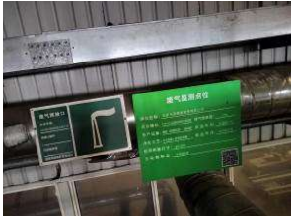
DA002 废气排放口及监测点位标识牌
