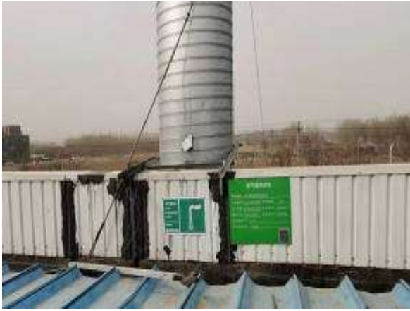
DA001 废气排放口及监测点位标识牌
