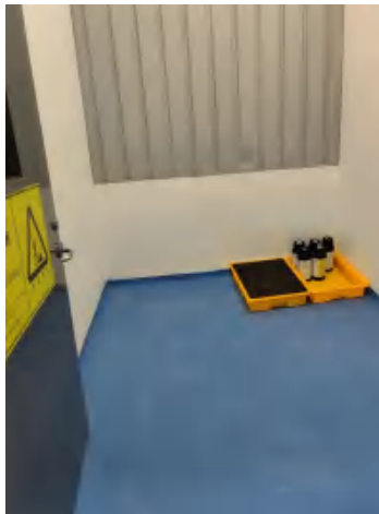
危险废物暂存间地面防渗及托盘
