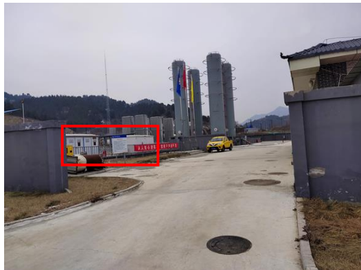
项目南侧（红框：CNG调压箱）
