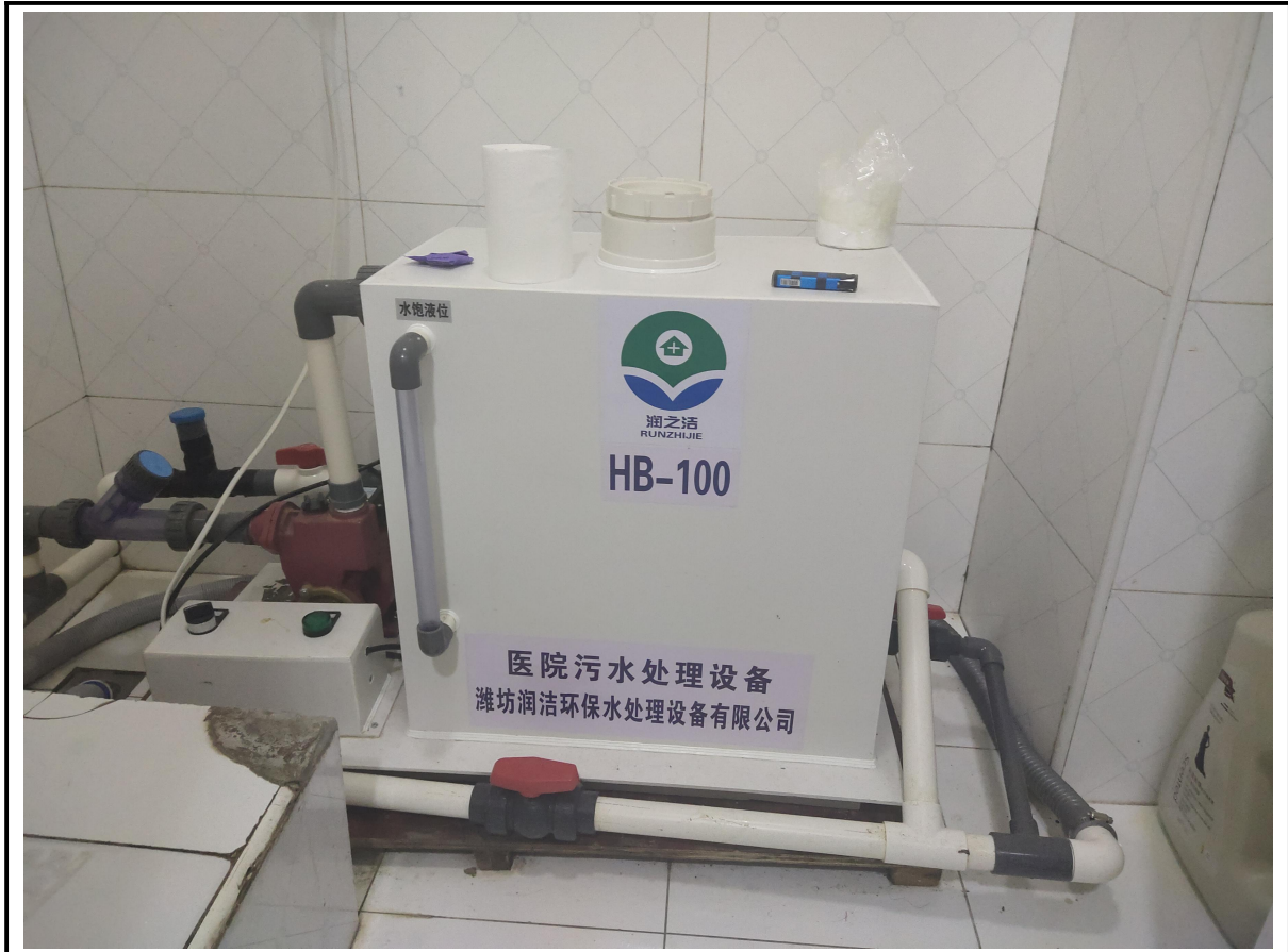
图 4 污水处理设备照片
