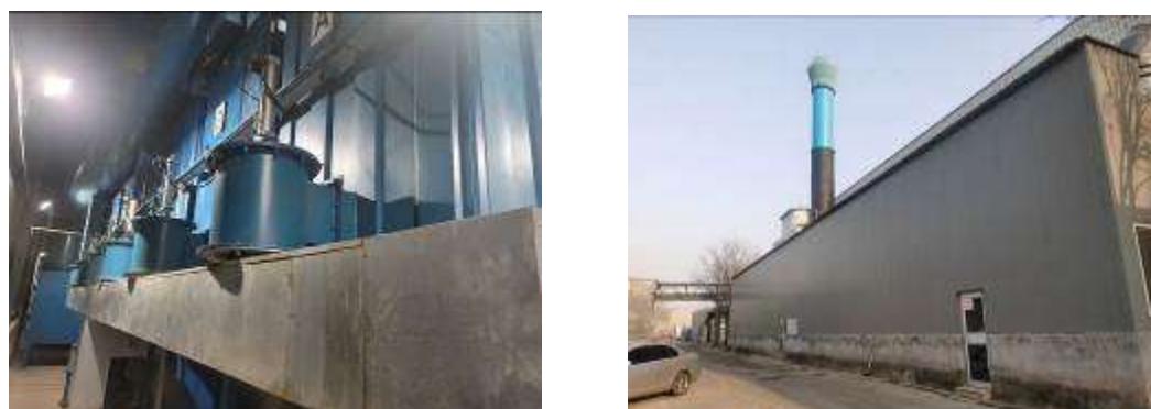
图 3-2 活性炭纤维吸附、脱附+催化燃烧现状照片
