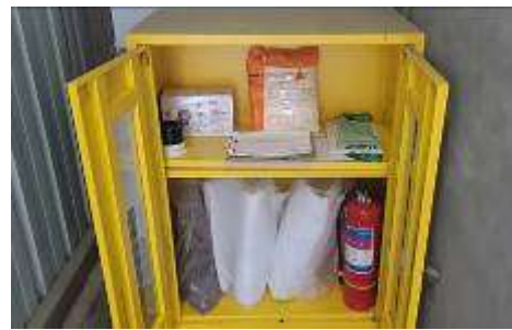
危险废物暂存间应急物资柜
