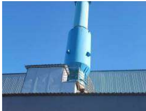
排气筒设置消音器
