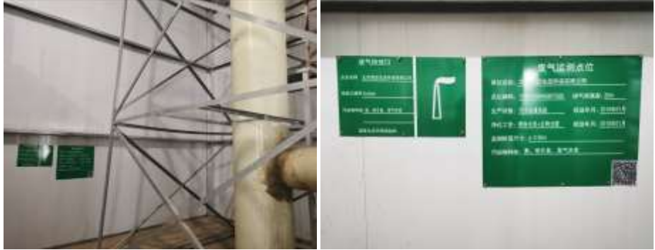
污水处理系统废气排放口 DA002 及监测点位标识牌
