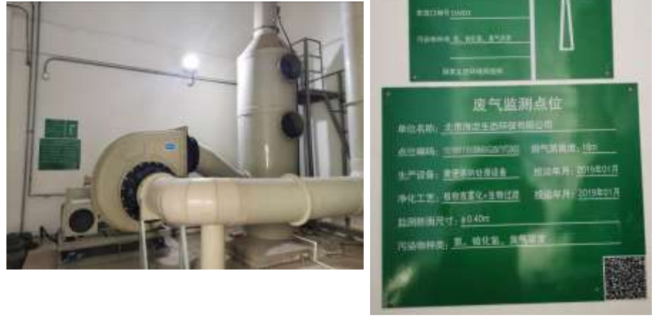
2#粪便消纳处理车间废气排放口 DA003 及监测点位标识牌
