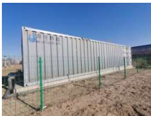
小营村污水处理站
