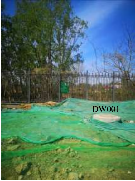
厂区废水总排口 DW001
