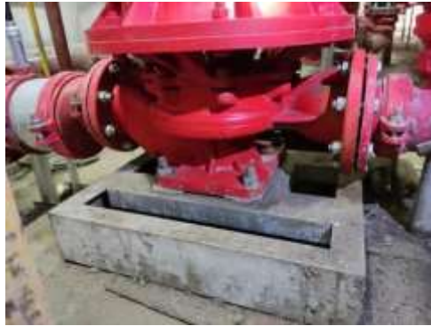
泵房水泵基础减振
