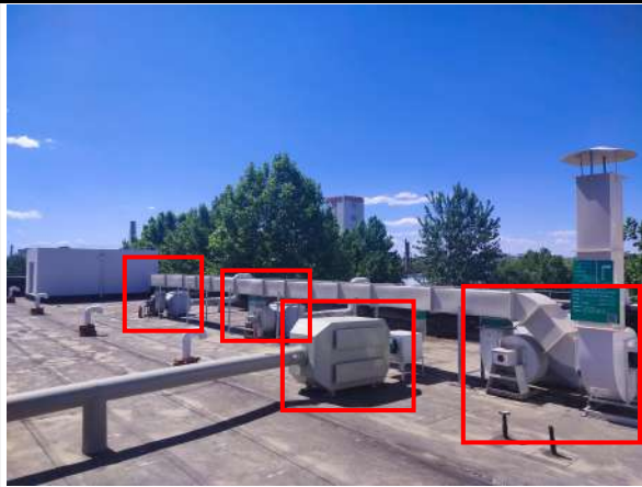
4 台活性炭吸附设备和综合楼顶排气筒
