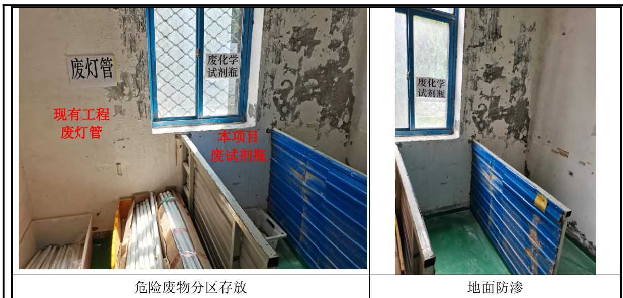
图 7 危险废物暂存现状照片
