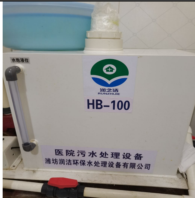
图 3-3 废水处理设施现状照片
