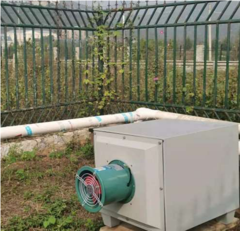
图 4-1 项目废气处理装置照片
