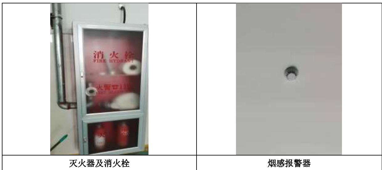
图 4-3 环境风险防范设施现状照片
