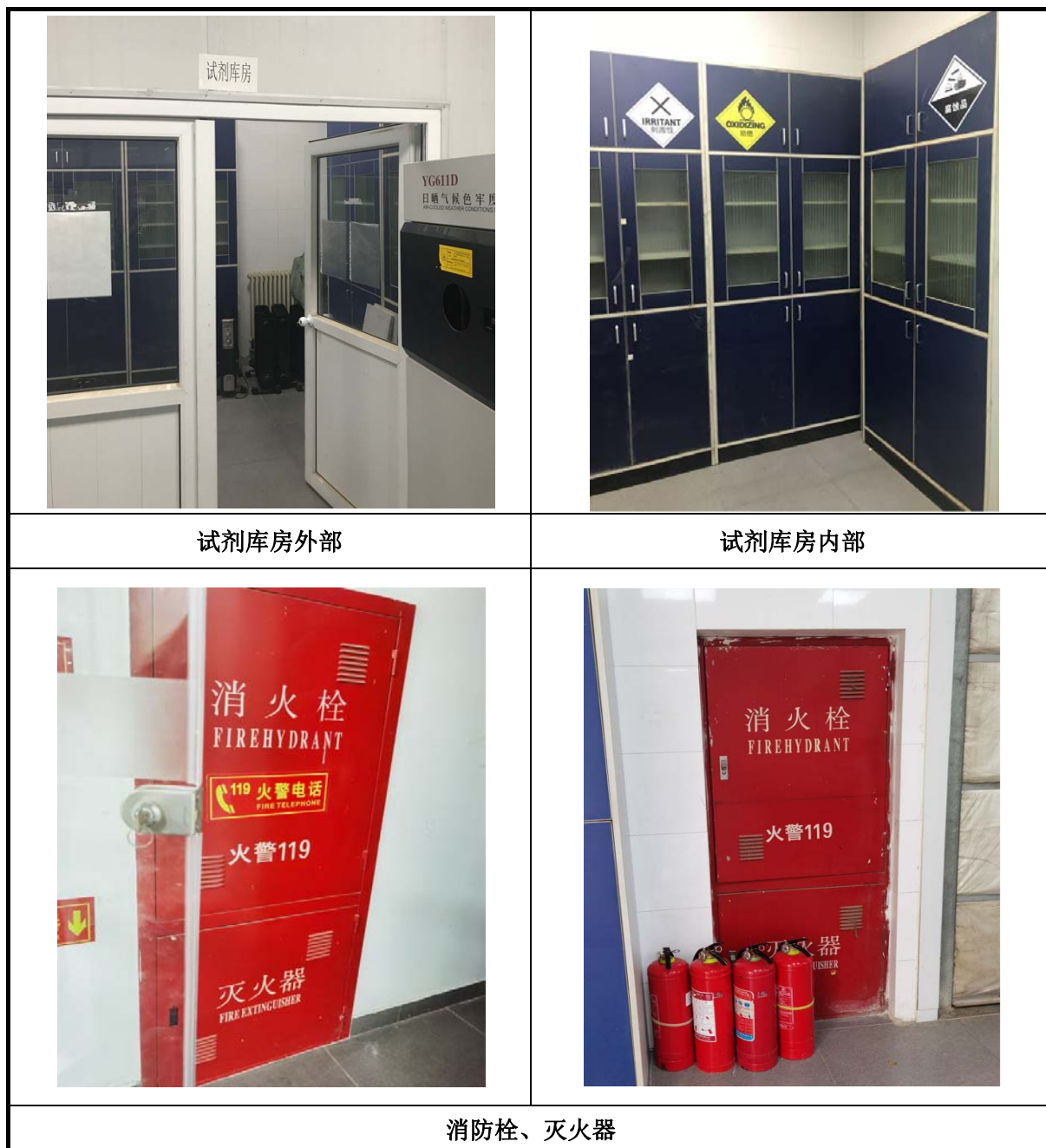
图 16 环境风险防范设施现状照片
