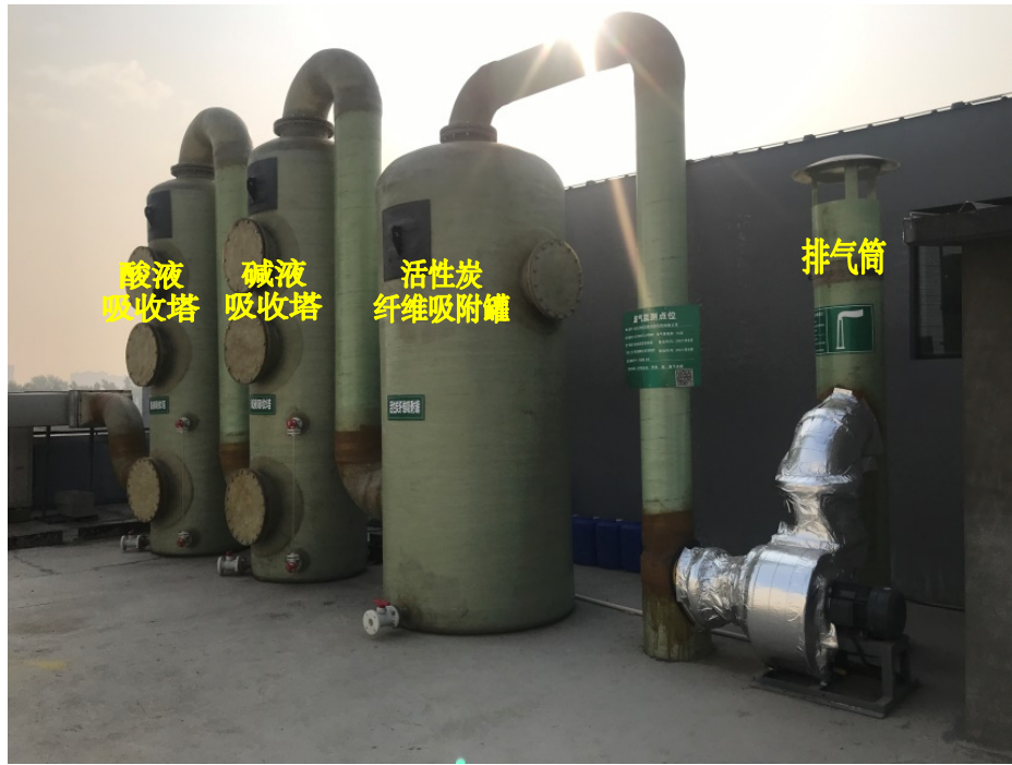
两级液相吸收（酸液碱液）+活性炭纤维吸附装置+排气筒
